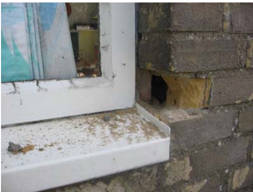
Asbesthoudende kit toegepast in raamkozijn (2-5% TRE, hechtgebonden)
