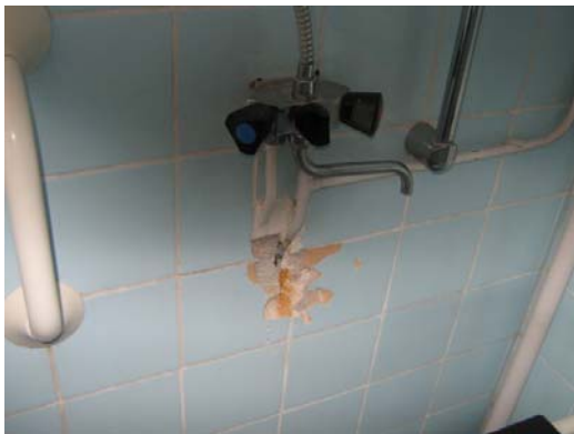
Asbesthoudende leidingisolatie rondom waterleiding van badkamer achter wandtegels (15-30% AMO, niet-hechtgebonden)
