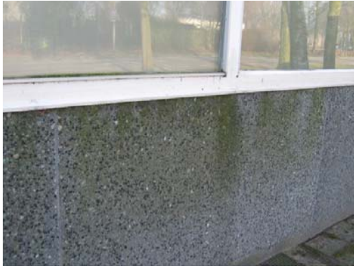
Asbesthoudende kit (grijs) tussen betonnen grindplaten buitenkant gevel (0,1-2% CHR, hechtgebonden)
