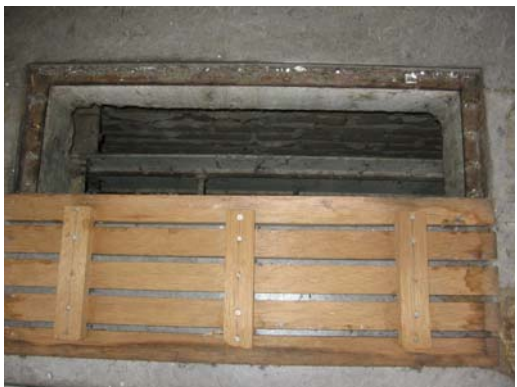
Asbesthoudend plaatmateriaal toegepast in convectorput van begane grondvloer (2-5% CHR, hechtgebonden)
