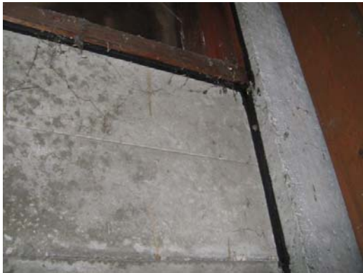
Asbesthoudende kit (zwart) tussen betonnen gevelplaten (10-15% CHR, hechtgebonden)
