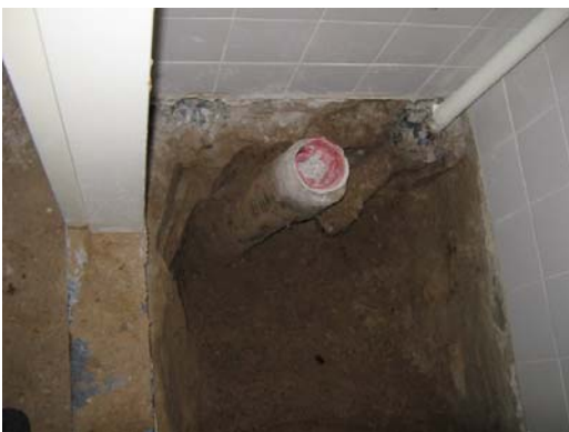
Asbesthoudende afvoerbuus van riolering toilet (10-15% CHR, hechtgebonden)
