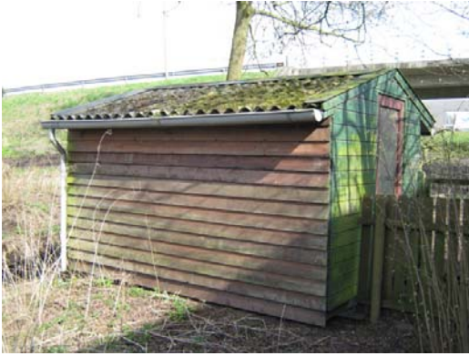
Asbesthoudende golfplaten toegepast als dak van kippenhok (10-15% CHR, hechtgebonden)
