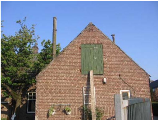
Asbesthoudende rookgasafvoerbuïs (10-15% CHR, hechtgebonden)
