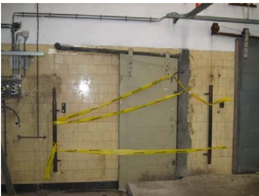
Asbesthoudende branddeur, plaatmateriaal verwerkt in de stalen deur, geen analyse uitgevoerd.
