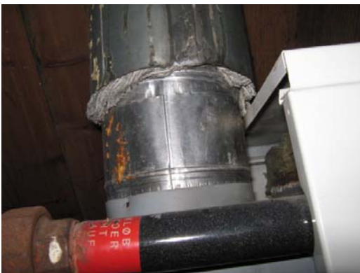
Asbesthoudend afdichtingkoord van rookgasafvoerkanaal bij c.v. installatie ( > 60% CHR, niet-hechtgebonden)
