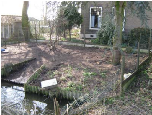
Asbesthoudende golfplaten toegepast als beschoeiing van watergang (10-15% CHR & 2-5% CRO, hechtgebonden)
