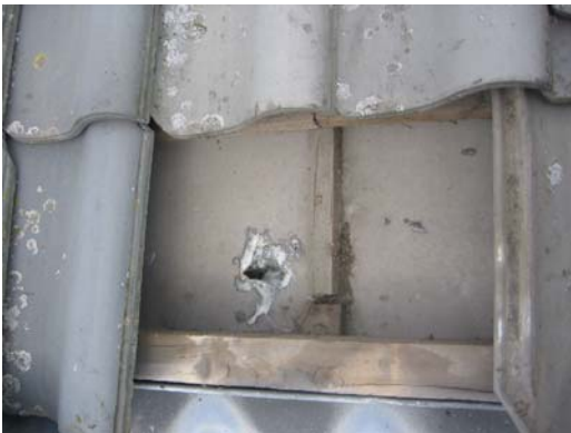
Asbesthoudend plaatmateriaal toegepast als dakbeschot onder dakpannen (2-5% CHR, hechtgebonden)
