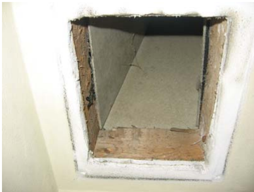
Asbesthoudende ontluchtingskoker van toiletruimte (10-15% CHR, hechtgebonden)
