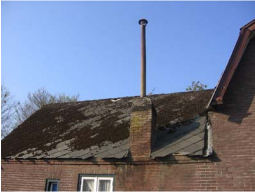
Asbesthoudende dakleien (10-15% CHR)
