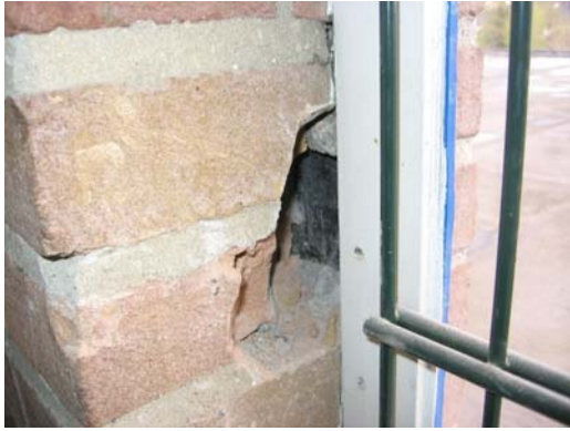
Asbesthoudende spouwstroken toegepast langs stalen raamkozijnen (10-15% CHR, hechtgebonden)
