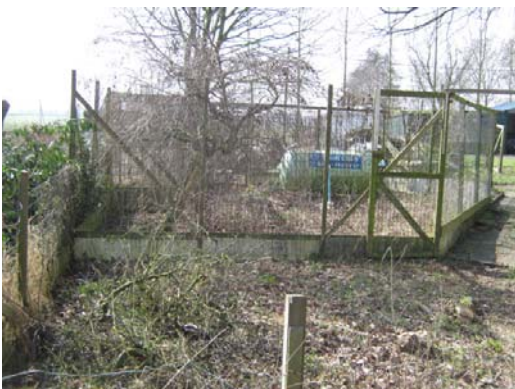
Asbesthoudend plaatmateriaal toegepast aan de onderzijde van de afrastering in de tuin (10-15% CHR, hechtgebonden)
