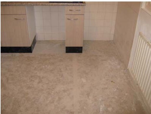
Asbesthoudend vloerzeil incl. lijmlaag aangetroffen in een keuken van flatwoning (0,1-2% CHR, hechtgebonden)
