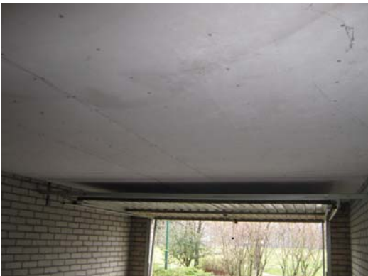
Asbesthoudend plaatmateriaal toegepast als plafond van garage (15-30% AMO, niet-hechtgebonden)
