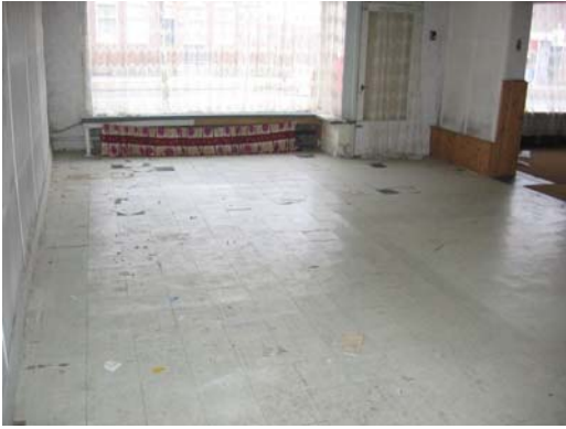
Asbesthoudende colovinyltegels met asbesthoudende lijmlaag (0,1-2% CHR, hechtgebonden)
