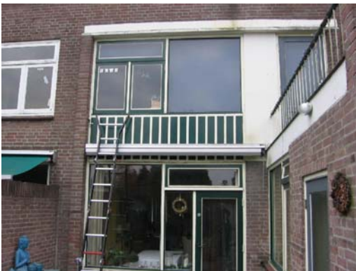
Asbesthoudend plaatmateriaal toegepast als gevelplaat, sandwichpaneel (10-15% CHR, hechtgebonden)
